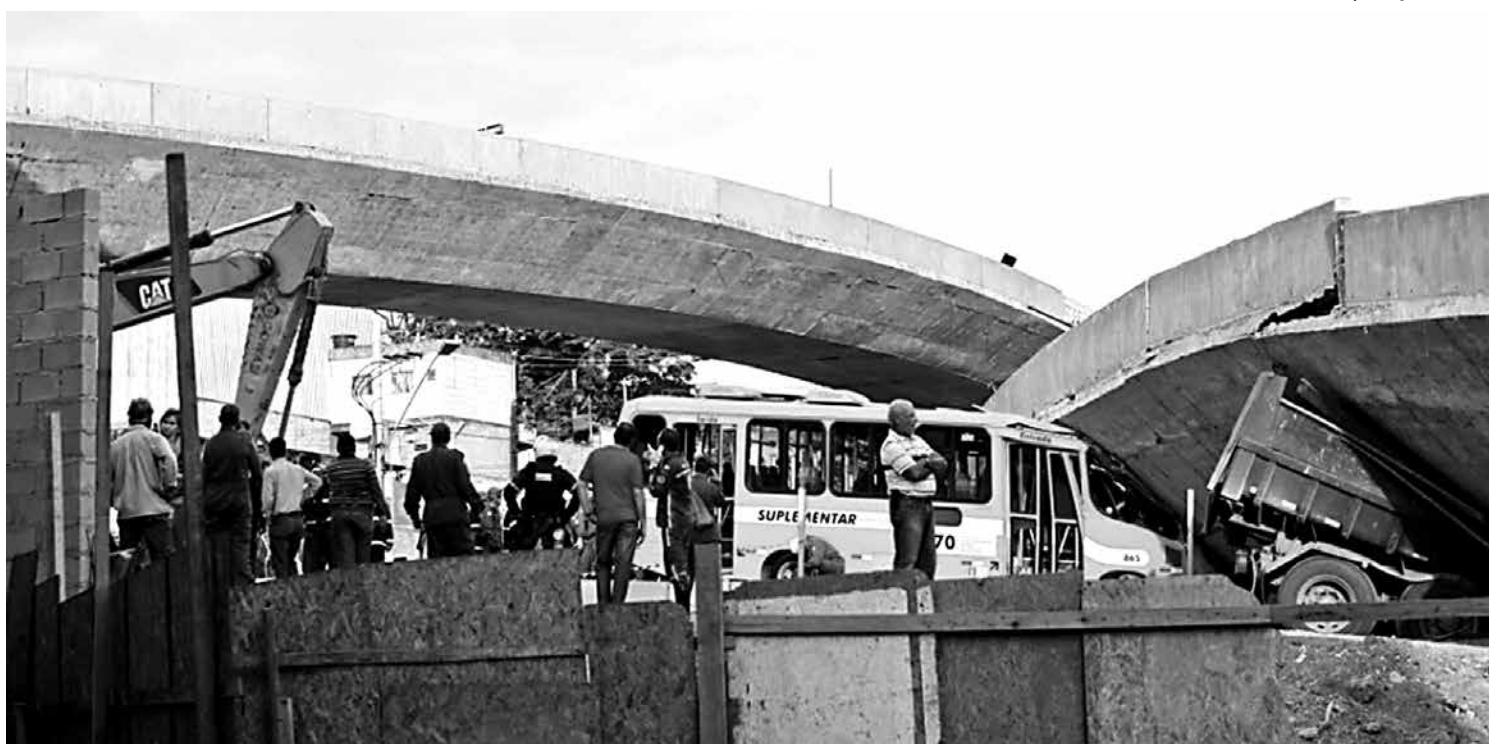
Na última quinta-feira, um viaduto em construção que liga obra da Copa desabou em Belo Horizonte, matou duas pessoas e feriu 23
